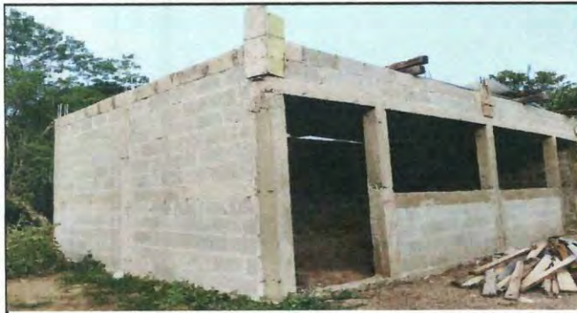
Foto 1: La cocina no cuenta con entechado, se necesita hacerle una instalación de cubierta de láminas y estructura de techo.
